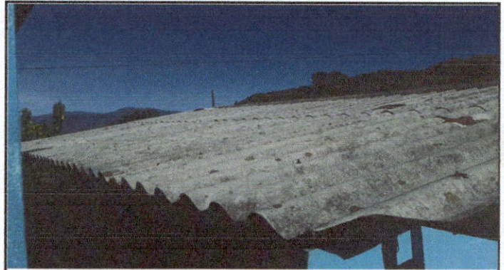
Foto 2: Techo en mal estado
