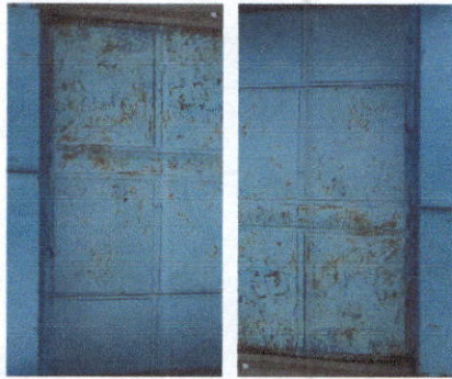
Foto 1: Porton en mal estado
